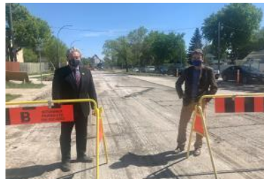
Avec le conseiller Mayes, je constate le progrès du travail sur le chemin Dunkirk
